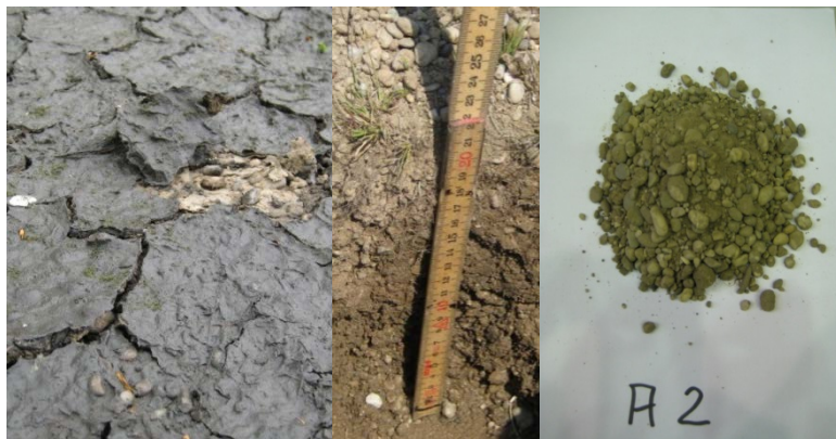
Abbildung 80: 1-Schicht-Bodenfilter Anlage A2, links: abgeplatzte Filteroberfläche der Anlage A2 im Bereich MP2, mittig: Schurf der Anlage A2 im Bereich MP4 und rechts: getrocknetes Filtersubstrat der Anlage A2
